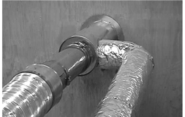
Figure 4 – Vue intérieure de l'extrémité de l'évent
